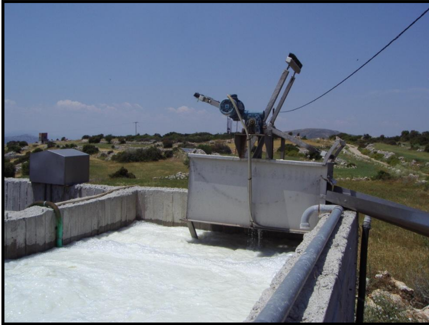
Εικόνα 1.9. Εγκατάσταση “βιολογικού καθαρισμού” του τυροκομείου - Δεξαμενή αερισμού
