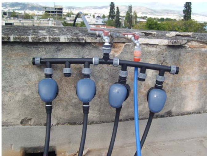
Εικόνα 13: Παροχή νερού και προγραμματιστές ηλεκτροβάνας αρδευτικού.
