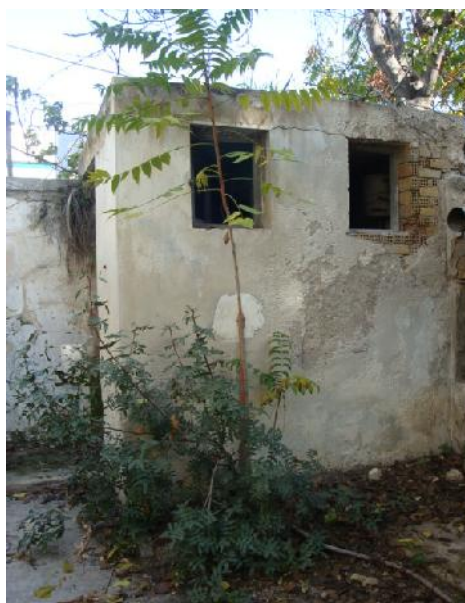
Εικόνα 84. Εικόνα της οικίας που πρόσφατα κατασκευάστηκε (α) και μια εξωτερική τουαλέτα (β)
