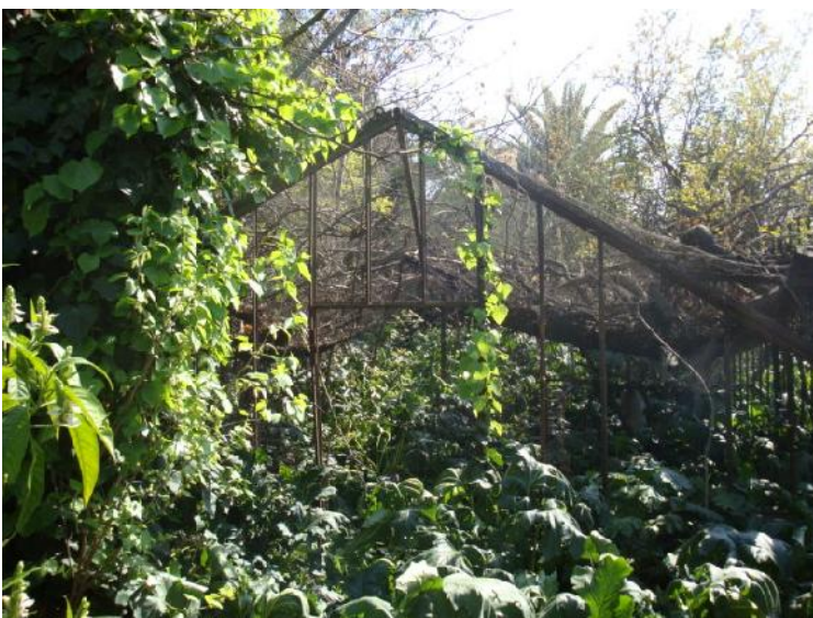
Εικόνα 82. Εικόνα του σπορείου, είναι εμφανής η φθορά της κατασκευής
