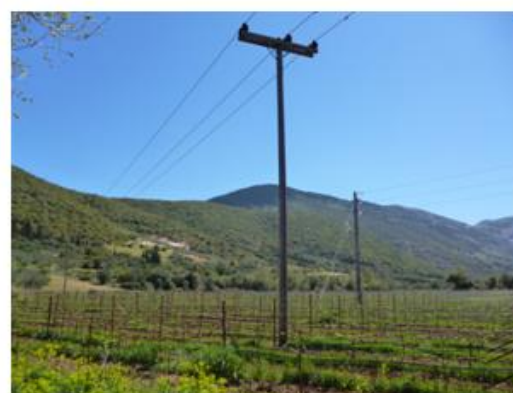
Εικόνα 4.36: Πυλώνες της ΔΕΗ εντός αμπελώνα
