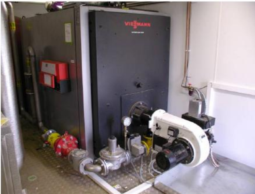
Καυστήρας βιοαερίου για παραγωγή θερμότητας (AGRINZ GmbH, 2008)( εικόνα 14)
