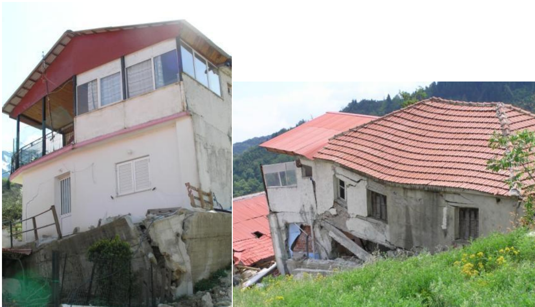
Φωτογραφία 6.37α & β: Η ίδια οικία του οικισμού μετά την κατολίπηση του 2010 (με ελαφριές ζημιές) και του 2012 (ακατοίκητη). Η φωτογραφία δεν λήφθηκε από το ίδιο σημείο γιατί το 2012 δεν υπήρχε πρόσβαση από τα κατάντη.
