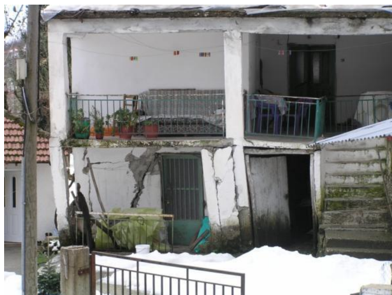
Φωτογραφίες 6.18, 6.19 & 6.20: Ολοσχερής καταστροφή σε οικίες (2010).
