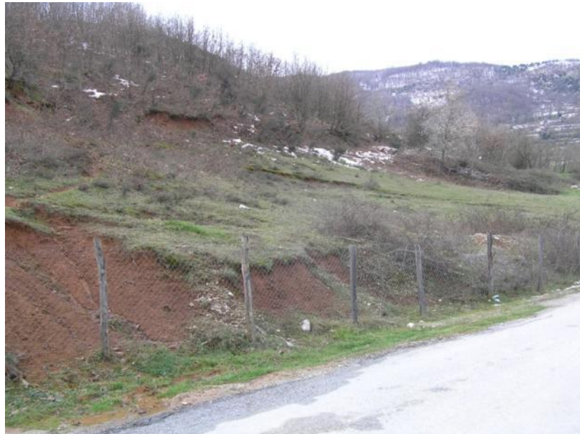
Φωτογραφίες 6.10 & 6.11: Θραύσεις και μετακινήσεις στον συνοικισμό του Αγίου Ιωάννη (2010).
