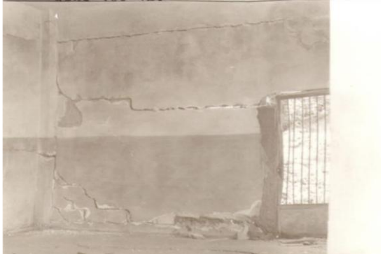
Φωτογραφία 6.4: Οριζόντιες ρωγμές στην οικία, που κατεστράφη και εντοπίζεται στον πόδα της κατολισθαίνουσας περιοχής. Έχουν ενεργοποιηθεί οι ανάντη χαλαρές μάζες του μανδύα του φλύσχη, που περιλαμβάνουν υλικά μέχρι βάθους 1 μέτρου περίπου κάτω από το δάπεδο της οικίας (Κούκης, 1979).
