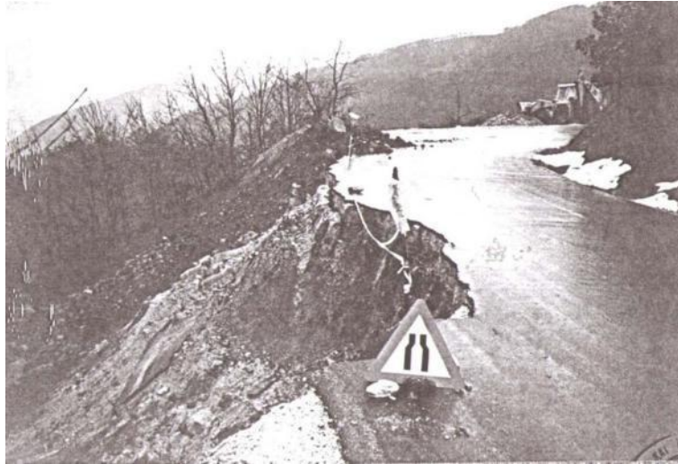
Φωτογραφία 6.7: Η μερική καταστροφή του οδοστρώματος από εδαφικές μετακινήσεις (Αποστολίδης, 1994β).
