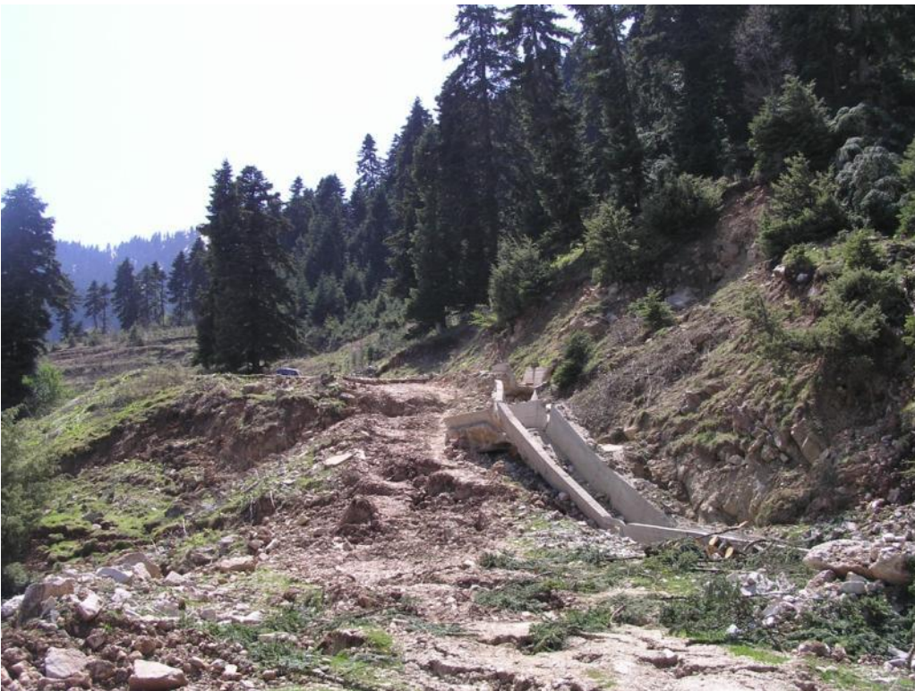
Φωτογραφίες 6.31 & 6.32: Φωτογραφίες κοντά στην κορυφή της κατολίσθησης, στις οποίες φαίνονται η «ανύψωση» περισσότερο του 1 μέτρου της γεώτρησης υδρομάστευσης της πηγής και η καταστροφή της συλλεκτήριας τάφρου των υδάτων (2010).
