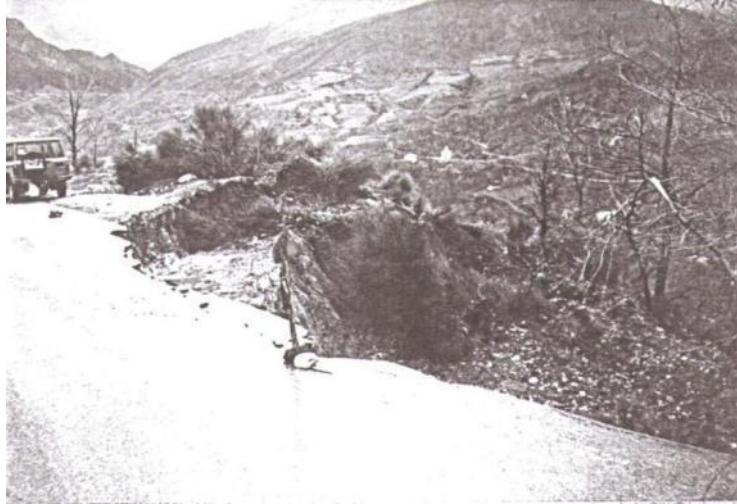
Φωτογραφία 6.9: Η καταστροφή τμήματος του οδοστρώματος από τις εκδηλωθείσες εδαφικές μετακινήσεις. Εμφανής είναι η κατακόρυφη μετακίνηση (άλμα) των εδαφικών υλικών (Αποστολίδης, 1994β).
