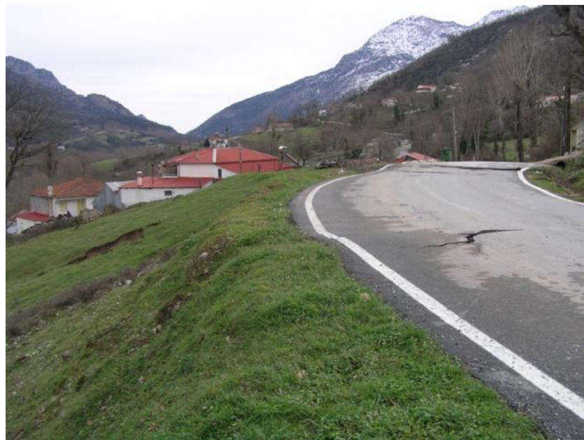
Φωτογραφίες 6.12 & 6.13: Θραύσεις και μετακινήσεις στον συνοικισμό του Αγίου Ιωάννη (2010).
