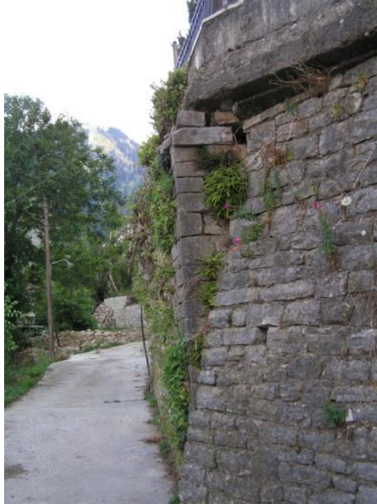
Φωτογραφία 6.33: Ο τοίχος υποστήριξης του προαύλιου χώρου της εκκλησίας. Η παραμόρφωση του τοίχου μας προϊδεάζει για την επερχόμενη εξέλιξη του φαινομένου (2010).
