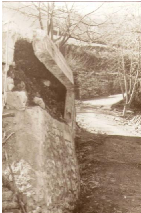
Φωτογραφία 6.5: Μαντρότοιχος κατάντη της ανωτέρω οικίας. Διακρίνεται μετατόπιση και καταστροφή του άνω μόνον τμήματος αυτού, που αντιστοιχεί στα χαλαρωμένα υλικά από του δαπέδου της οικίας και κάτω (πάχους 1 μέτρου περίπου) της Φωτογραφίας 6 (Κούκης, 1979).
