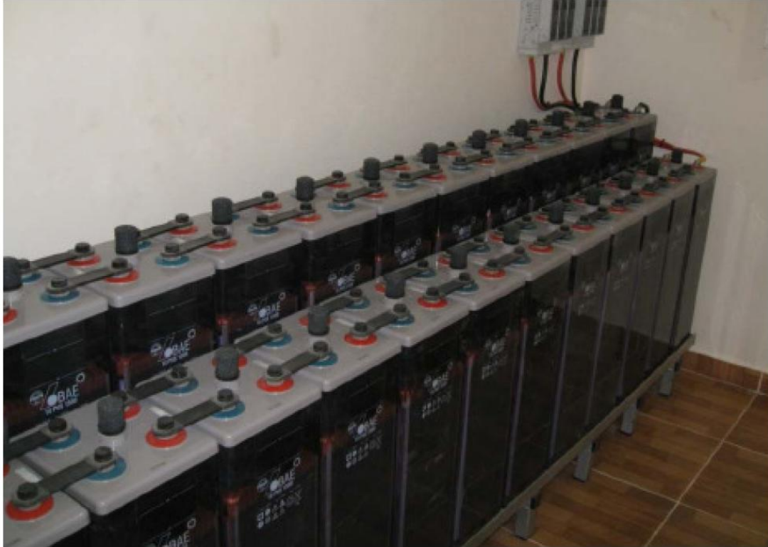
Εικόνα 4.7: Σύστημα αποθήκευσης ενέργειας με συσσωρευτές. (Πηγή: Παπαδάκης, 2009)
