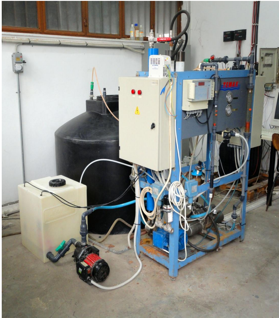
Εικόνα 7.18: Η μονάδα αφαλάτωσης αντίστροφης ώσμωσης
