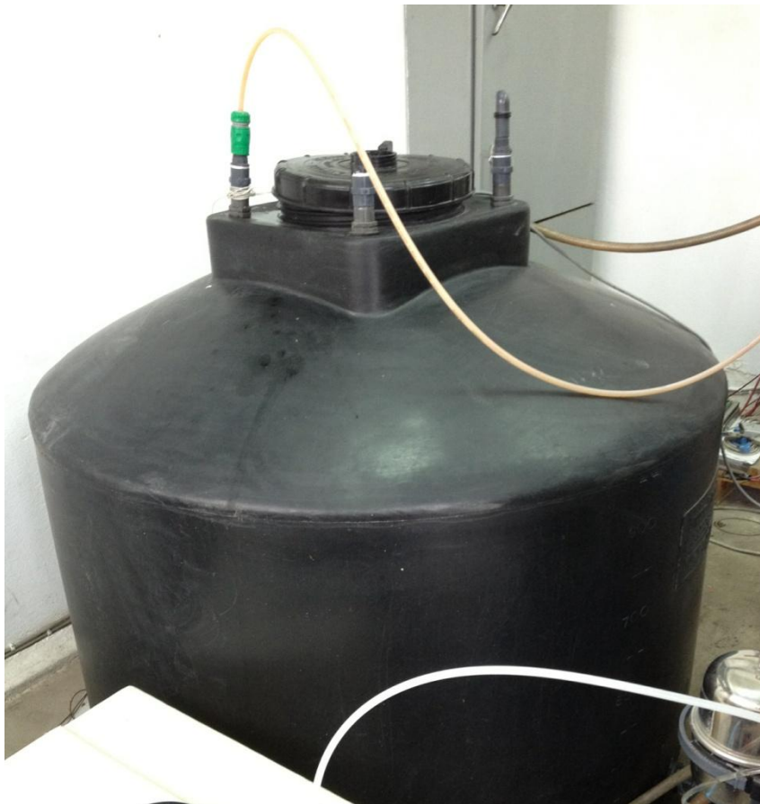
Εικόνα 7.1: Η δεξαμενή τροφοδοσίας
