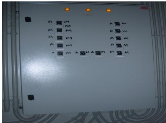
Εικόνα 1.7: Γενικός ηλεκτρικός πίνακας
