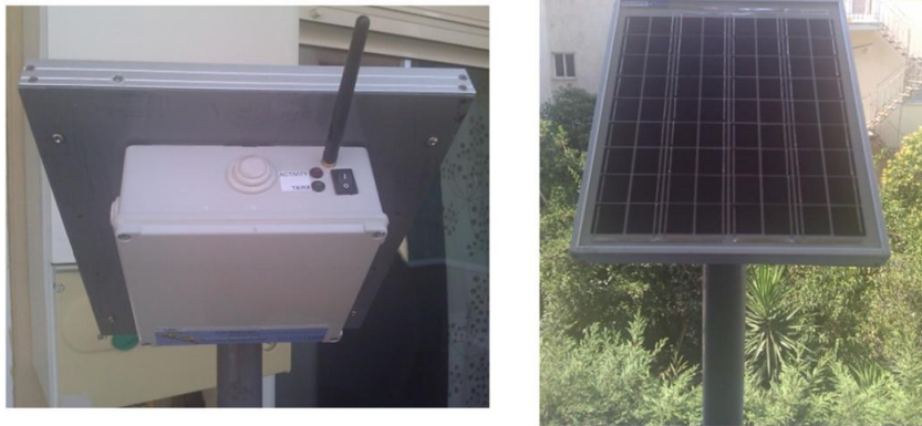
Εικόνα 5.3. Ασύρματος κόμβος σε ηλεκτρολογικό περίβλημα γενικής χρήσης στερεωμένο στο πίσω μέρος μεταλλικού ιστού.
