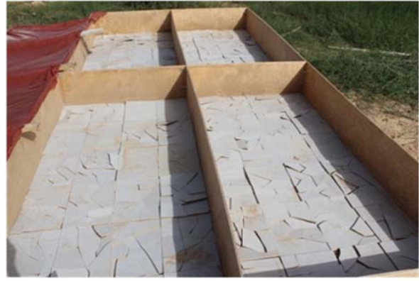
Εικόνα 51: Τα θραυστά κεραμικά πλακίδια στη βάση των καταχώσεων
