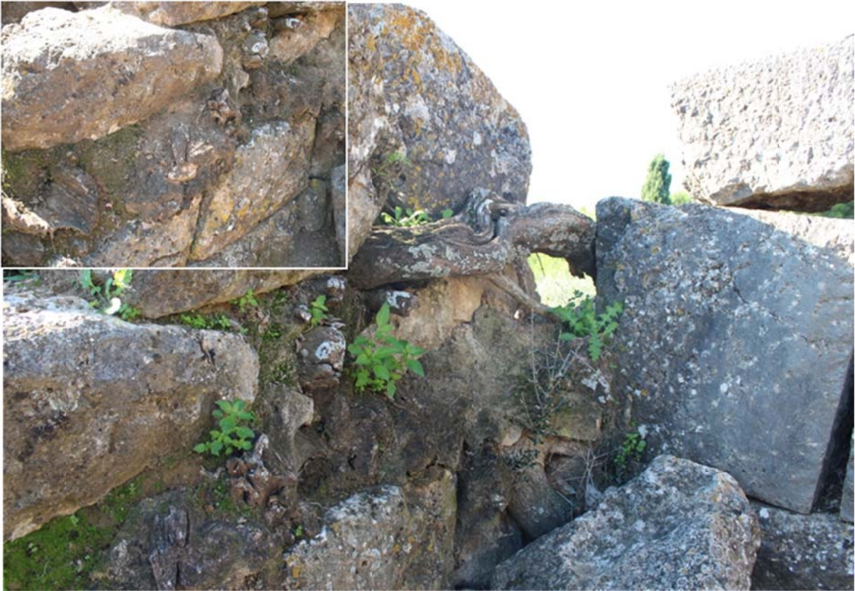
Εικόνα 10: Μηχανική ζημιά από την ανάπτυξη ριζικού συστήματος ελαιόδεντρου σε οχυρωματική τοιχοδομία στο Νεκρομαντείο Αχέροντα. Διακρίνεται ότι η ρίζα έχει υποκαταστήσει πλήρως το συνδετικό υλικό μεταξύ των λίθων (προσωπικό αρχείο, λήψη 2012)
