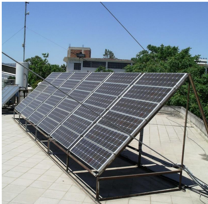
Εικόνα 7-6 Συστοιχία φωτοβολταϊκών πλαισίων
