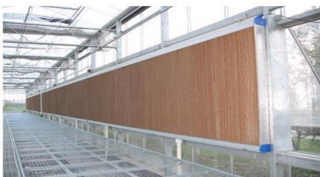
Εικόνα 7.8 : Σύστημα Wet Pad and Fan
