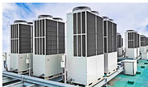
Εικόνα 7.9: Κεντρική μονάδα συστήματος HVAC
