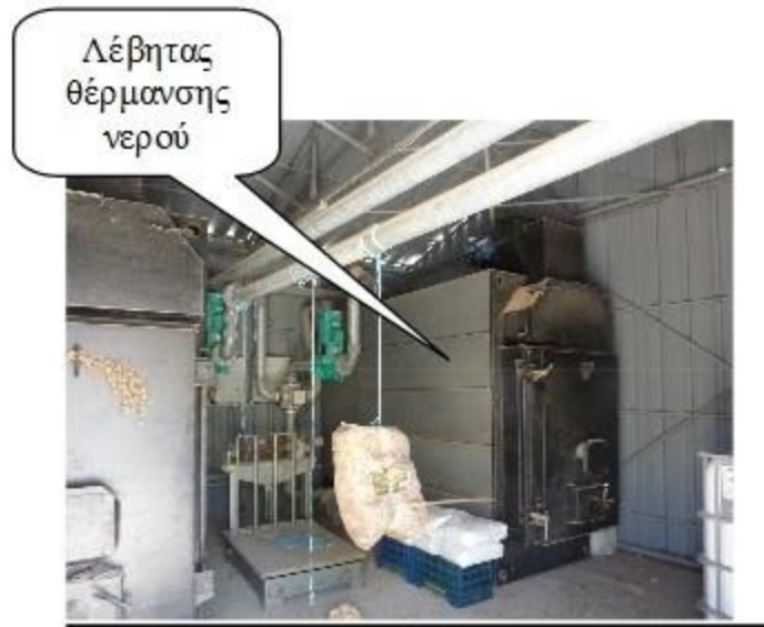
Εικόνα 15: Λέβητας θέρμανσης νερού (πηγή: μηχαν/γεωπ-blogger)
