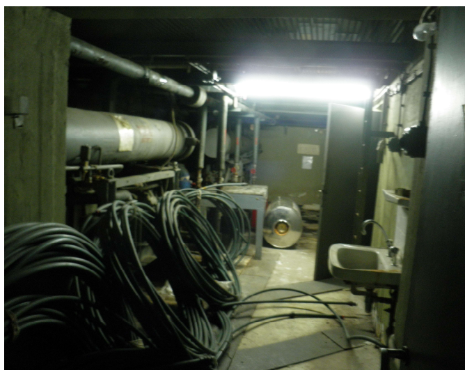
Εικ. 21: Χώρος Η/Μ Εξοπλισμού (Πηγή: Προσωπικό αρχείο)
