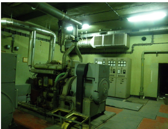
Εικ. 20: Χώρος Γεννήτριας (Πηγή: Προσωπικό αρχείο)
