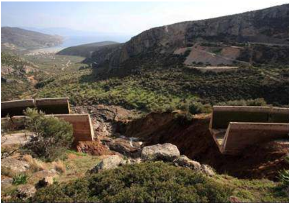
Σχήμα 3.14: Φωτογραφία της κατολίσθησης τμήματος του καναλιού Μόρνου στην περιοχή της Τοπικής Κοινότητας Προδρόμου Βοιωτίας.
