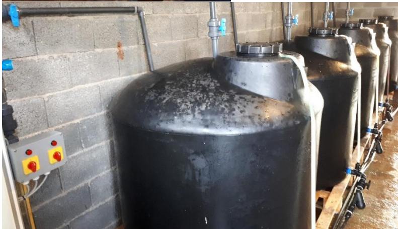
Εικόνα 7.13 Δεξαμενές αποθήκευσης πυκνών διαλυμάτων (πηγή: Φυτώρια Ανδρή).
