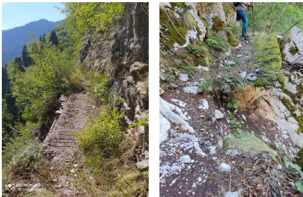
Εικόνα 5.15 & 5.16 Επικίνδυνα σημεία που χρήζουν άμεσης επισκευής- κατάρευση λιθοδομής. (φωτο: Γκορόγιας Ν.)
