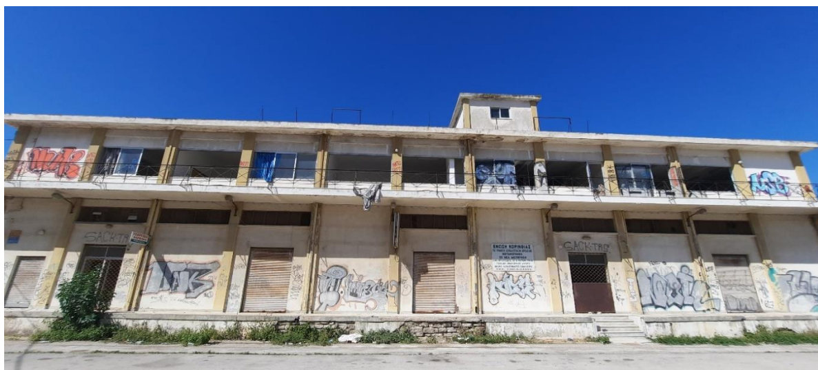
Εικόνα 25 Εγκαταλελειμένο κτήριο Ένωσης Αγροτικών Συνεταιρισμών Κορινθίας.
