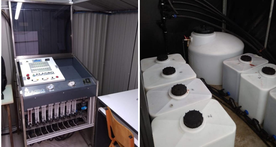
Εικόνα 16. Κεφαλή υδρολίπανσης (αριστερά) τύπου ALAGRO IQ60 και δεξαμενές πυκνών διαλυμάτων (δεξιά).
