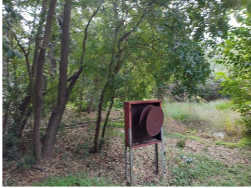
Εικόνα 38: Πυροσβεστική Φωλιά εγκαταλελειμμένη στην περιοχή των λιγούστρων. Φωτογραφία 17.10.2023
