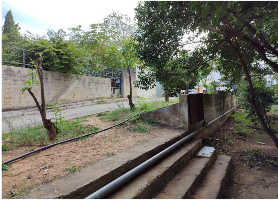
Εικόνα 23: Έλλειψη προσβασιμότητας σε σκάλα του εξωτερικού χώρου (μπροστά στην είσοδο του θερινού κινηματογράφου). Φωτογραφία 17.10.2023.
