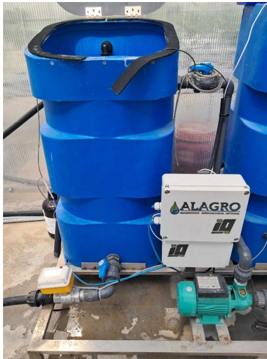
Εικόνα 1.9 Δεξαμενή αυτόματης αραιώσης πυκνών διαλυμάτων
